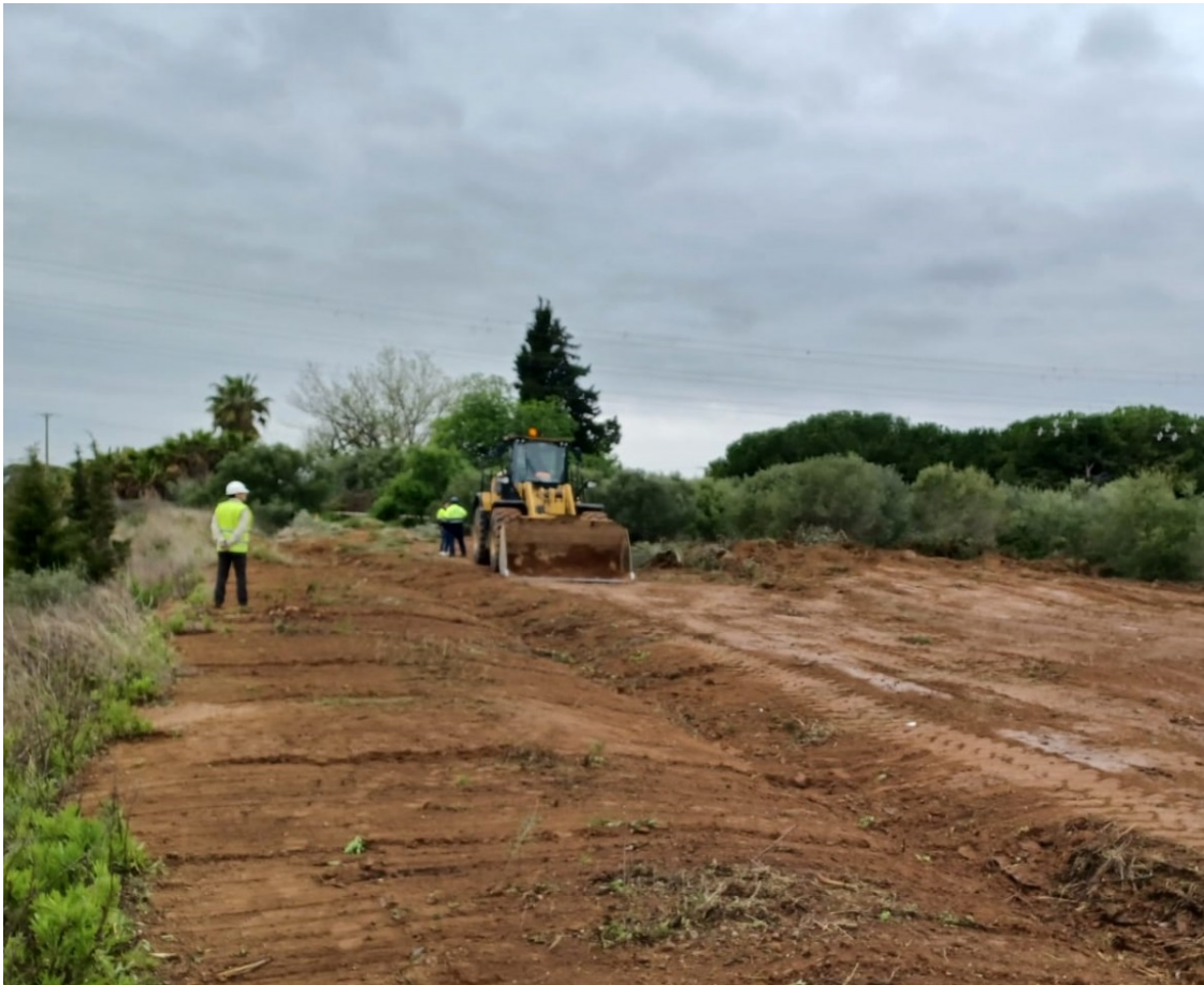
Adif inicia les obres de la nova estació de Salou-Port Aventura | Cedida
