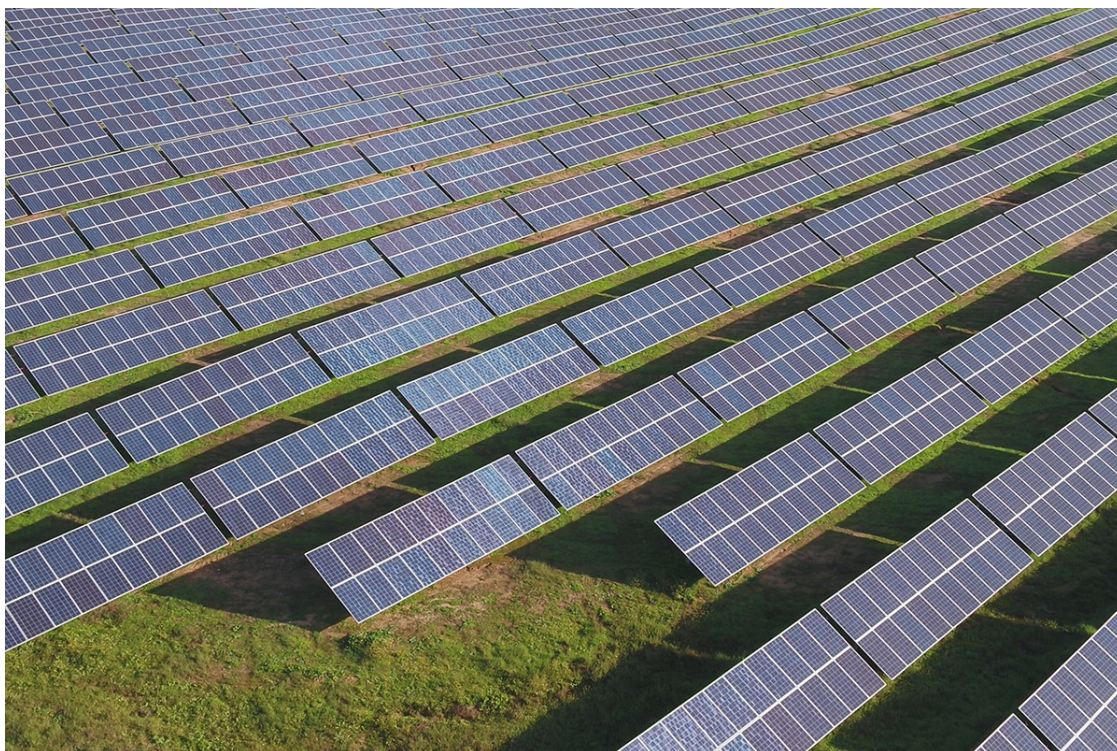
Vista general d'una planta solar fotovoltaica | ACN
