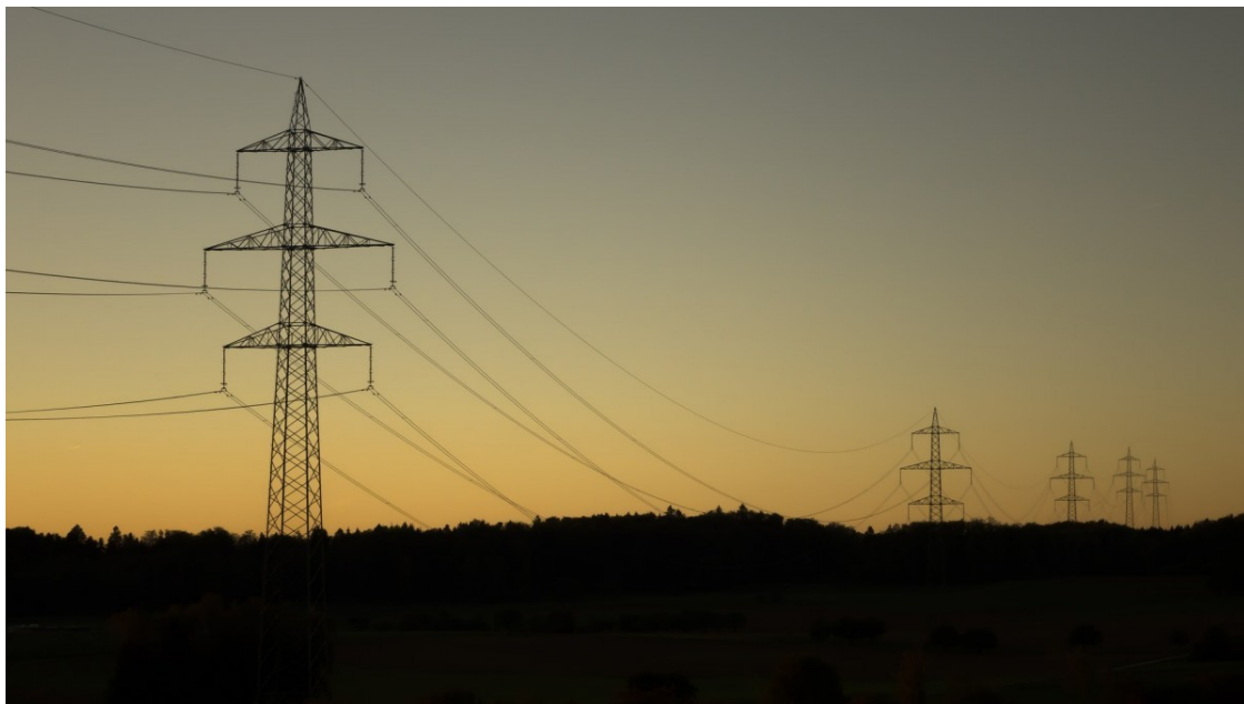
Línia de Molt Alta Tensió | Imatge d'arxiu
