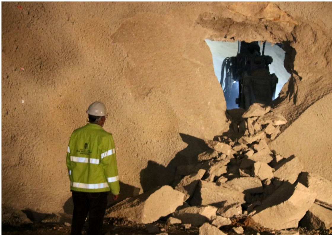
Obres al túnel de Lilla, en el marc del projecte de l'A-27 | ACN
