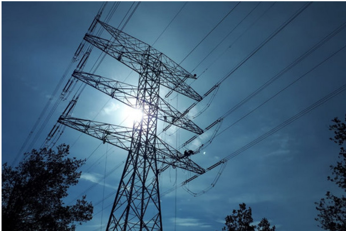
Imatge d'arxiu d'una de les torres d'una línia MAT | ACN
